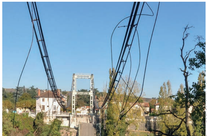
↑ Rupture des attaches au tablier des suspentes (câbles verticaux qui pendent) du pont suspendu de Mirepoix-sur-Tarn.
